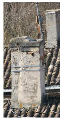
Souche en briques couronnement en pierre
