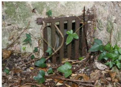
Grille verticale filtrant le conduit de la canalisation traversante du bâti. (A10 – A11)
