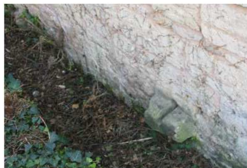
Pierre d'évacuation des eaux usées sur le caniveau
